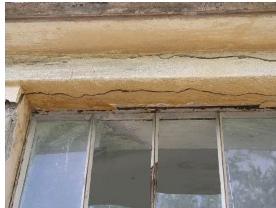
Oštećenje konstrukcije izazvano korozijom armature
