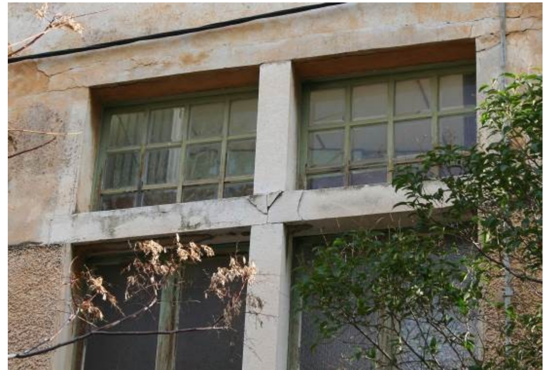
Oštećenje kamenih elemenata velikih otvora
