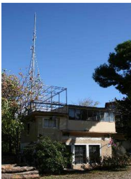
Slika 13. Neprimjerena dogradnja nad južnim volumenom i antena na sjevernom volumenom malog secesijskog restorana, današnje stanje
